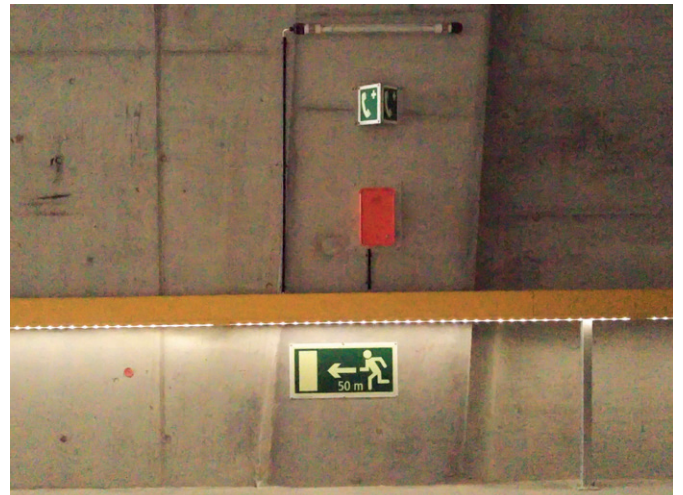
Segnalazione di direzione per la via di fuga
